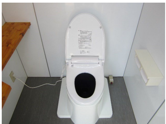
快適トイレ内部（暖房便座付き）
